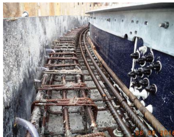
Figura 23 - Chapa de arranque pronta para a segunda concretagem, já com a armação de reforço fixada ao ferro "J"
