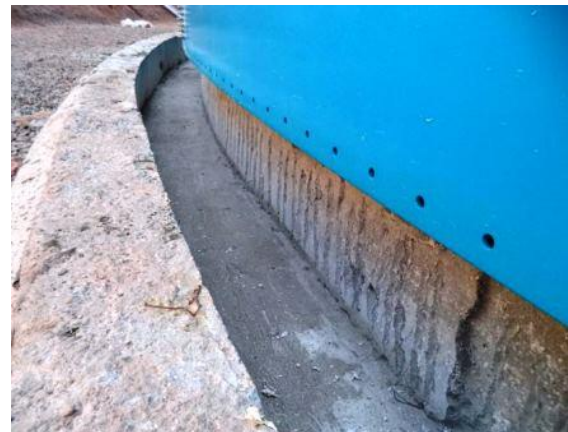
Figura 15 - Importante: Apicoar a canaleta para garantir a aderência da concretagem de consolidação
