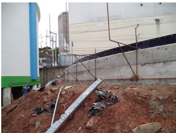
Figura 7 – Falta de espaço para montagem
