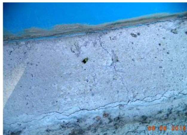
Figura 17 - Importante: Retração do concreto de preenchimento da canaleta alerta para a necessidade de cuidados especiais na sua especificação e aplicação
