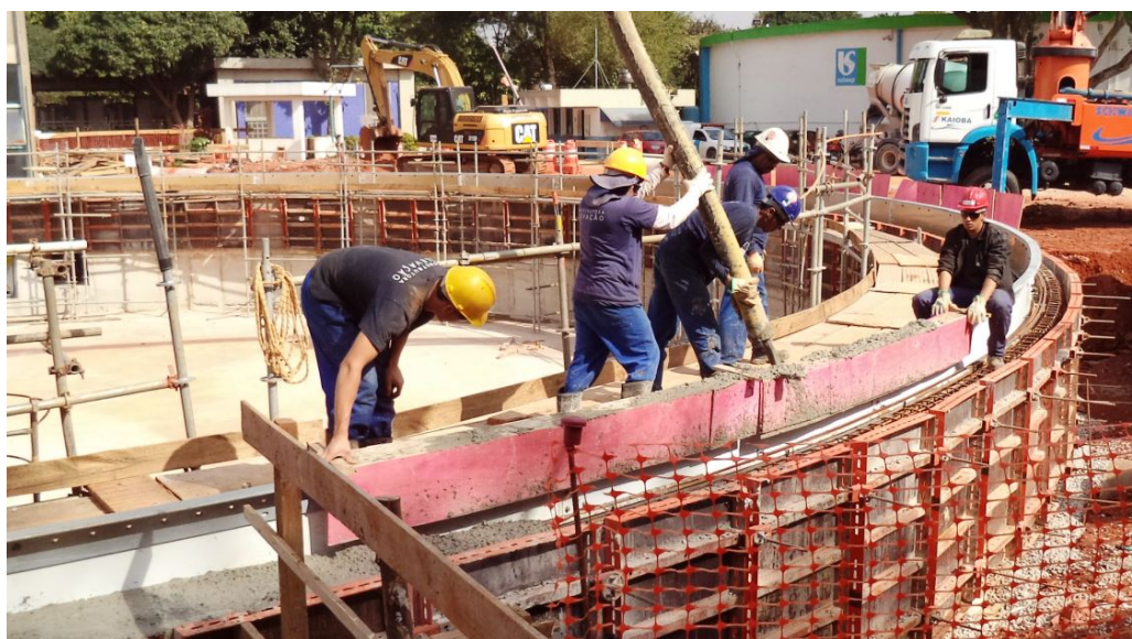
Figura 19 - Dano potencial à chapa de arranque que precisa ser adequadamente protegida durante a concretagem
